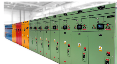
PT Kraków Płaszów - 23 połowa RPS z ilością ponad 170 modułów elektronicznych sterownika CZAT7
