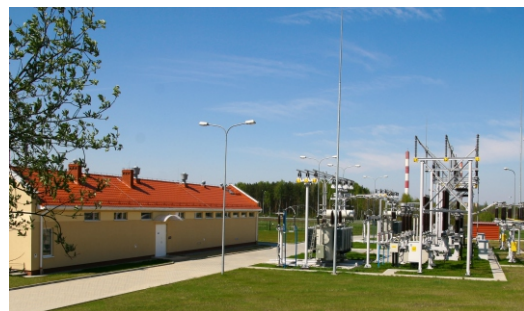
RPZ PKP 110/15 kV Łódź Olechów
