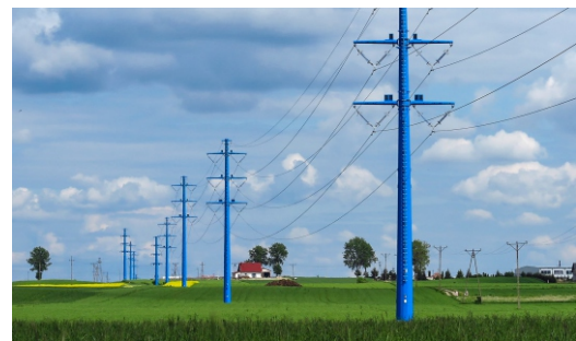
Linia zasilająca 110 kV
