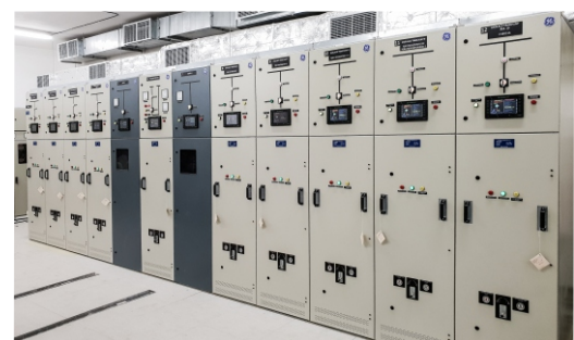
Rozdzielnica prądu stałego – Metro Warszawa
