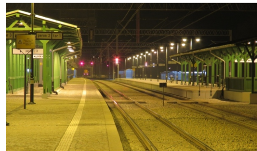
Zaprojektowanie i wykonanie systemu sterowania energetyką niskiego napięcia (m.in.: oświetlenia peronów, oświetlenia przejść podziemnych, ogrzewania rozjazdów) – – zabytkowa stacja Wrocław Leśnica
