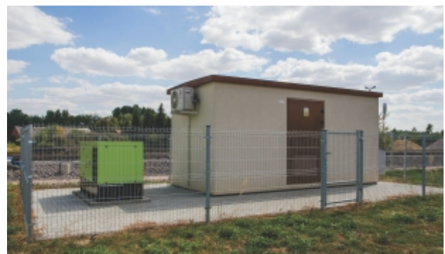
Kontener komputerowni - stacji Niedrzwica
