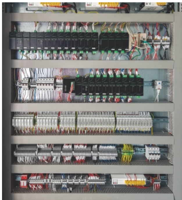
Szafa systemu PERUN wyposażona w moduły CZAT7
