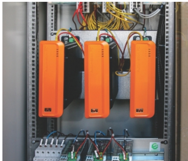
Widok szafy komputerów zależnościowych
