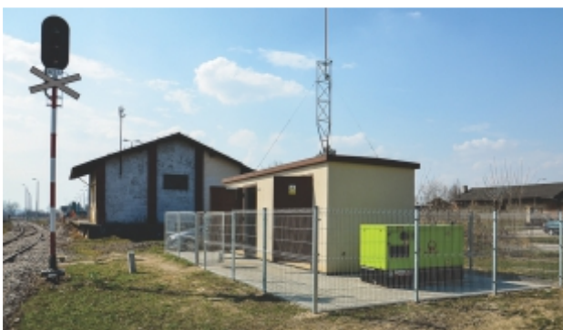
Kontener komputerowni - stacji Wilkołaz
