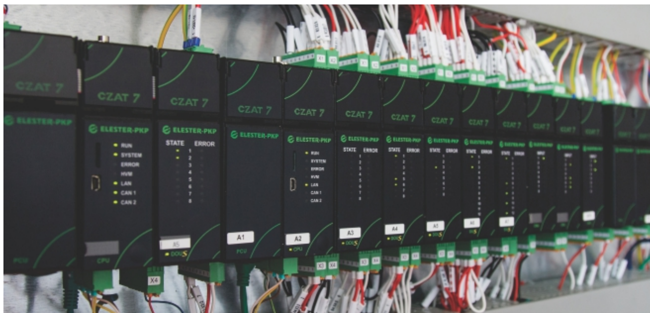
Zestaw modułów CZAT7 odpowiedzialny w systemie PERUN za realizację funkcji logicznych i działanie warstwy wykonawczej.
