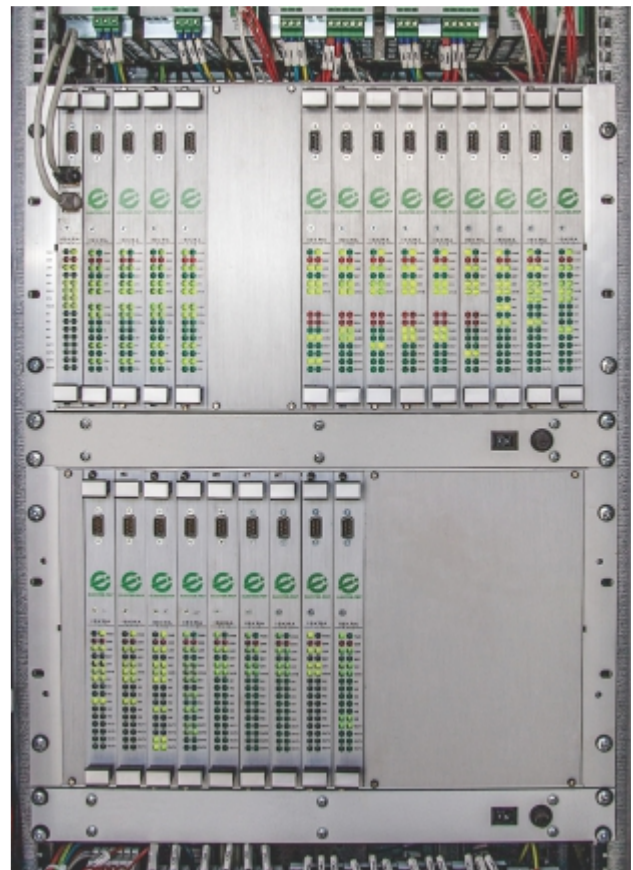
Widok szafy komputera wykonawczego wraz z kartami sterowników obiektowych
