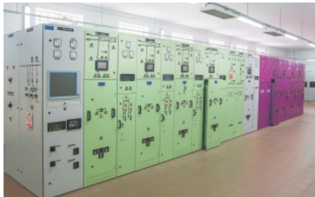
Stacja prostownikowa Ćmielowska (Tramwaje Warszawskie). Stacja obsługiwana przez System Automatyki Trakcyjnej. Rozdzielnia prądu stałego wyposażona w automatykę zabezpieczeniową CZAT. Zdalne sterowanie wszystkimi stacjami prostownikowymi Tramwajów Warszawskich odbywa się z Centralnej Dyspozytorni Energetycznej CDE zaprojektowanej i zrealizowanej przez ELESTER-PKP.
