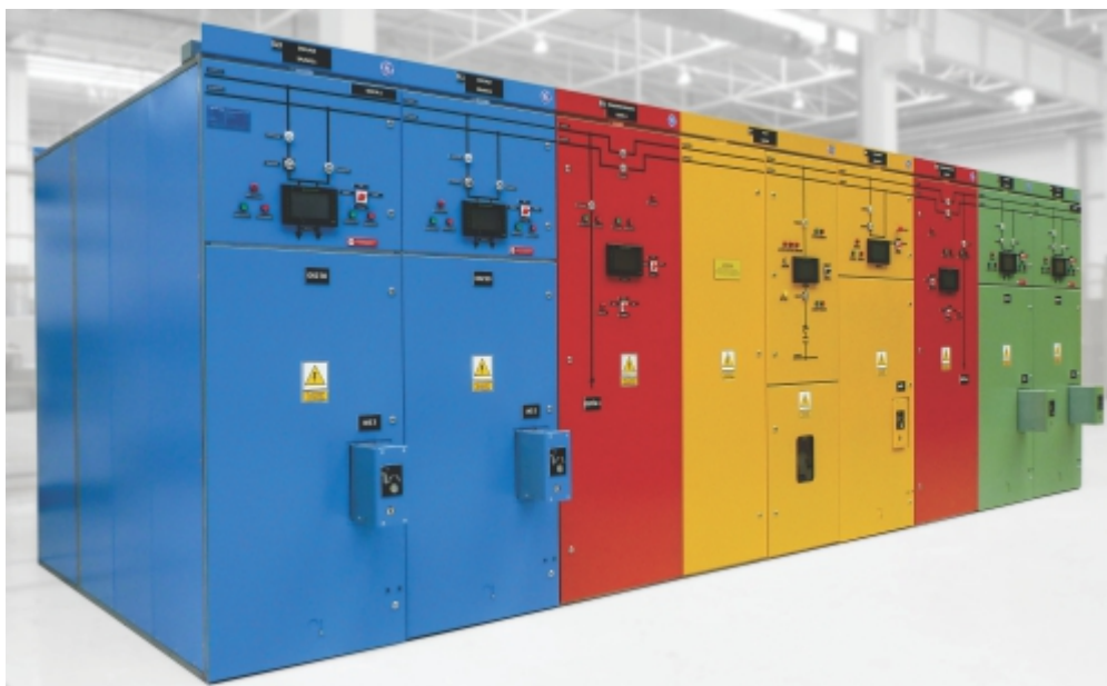
Rozdzielnica prądu stałego wyposażona w automatykę CZAT7. Jest to rozdzielnica 3 kV o największej obciążalności prądowej w Polsce, stosowana na obiektach zasilania linii kolejowych Warszawa-Poznań, Warszawa-Białystok i Poznań-Szczecin.
