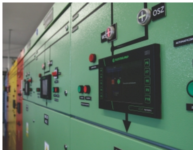
Automatyka CZAT z panelem CZAT Synoptic w polu zasilacza trakcyjnego rozdzielni prądu stałego (PT Łachów - PKP Energetyka)
