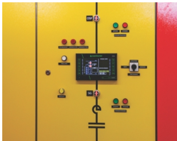
Automatyka CZAT z panelem CZAT Synoptic w polu filtra gamma rozdzielnicy prądu stałego (PT Łachów-PKP Energetyka)
