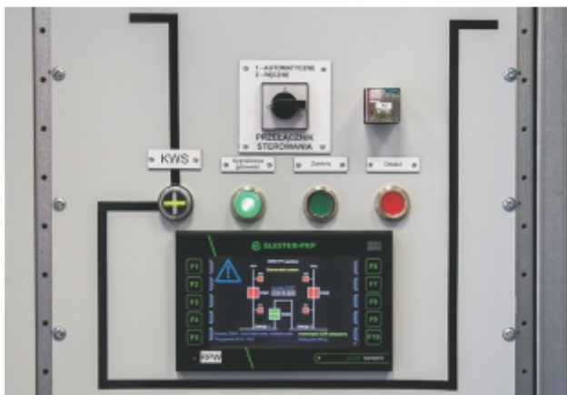
Sterownik CZAT, z panelem CZAT Synoptic, w rozdzielni potrzeb własnych prądu przemiennego 400/230V, realizujący sterowanie zdalne oraz automatykę Samoczynnego Załączenia Rezerwy (SZR)
