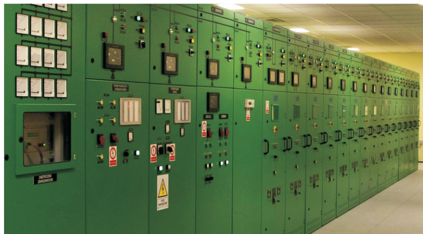
Traction substation „Rondo Kaponiera” in Poznan, Poland (MPK Poznań)
