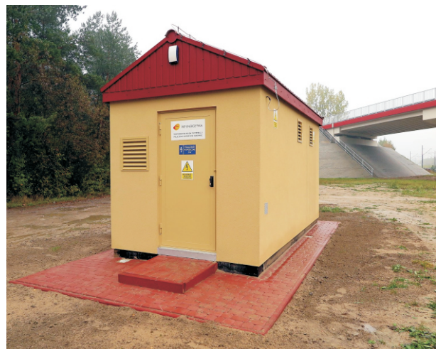
Kabina Połączenia Poprznego KPP
