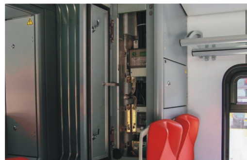
Pociąg FLIRT3 produkcji Stadler, wyposażony w licznik energii LE 3000plus. Część komunikacyjna umieszczona została w sąsiedztwie przegubu pojazdu, natomiast wysokonapięciowy przetwornik HVM wraz z bocznikiem zamontowany jest na dachu.
