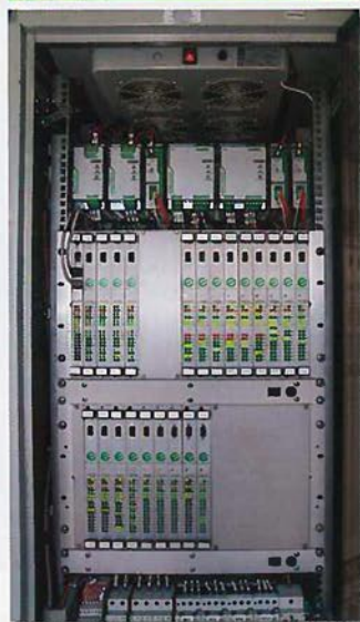
Szafa Komputera Wykonawczego wraz z kartami sterowników obiektowych
