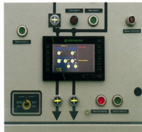
Panel operatorski CZAT Synoptic umieszczony w polu zasilacza trakcyjnego rozdzielni prądu stałego
